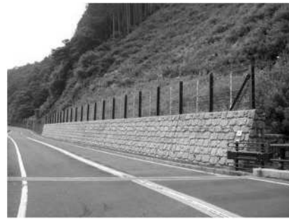
落石防護柵工
