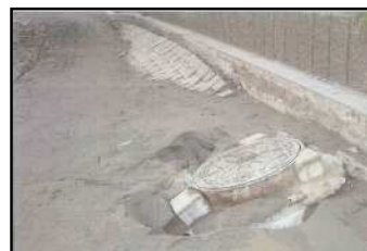
液状化による浮上(新木場)
