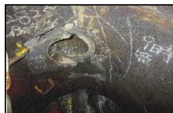
接続部の破損(新木場)
