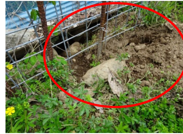
鳥獣に地面を掘られ隙間が生じている箇所
