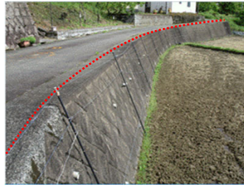
柵の高さが法面と同程度しかなく侵入防止効果がない箇所
