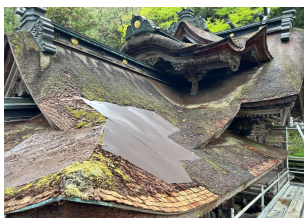
檜皮葺屋根の経年毀損 (金属板にて応急処置) 【重要文化財 大瀧神社本殿及び拜殿 (福井県越前市)】
