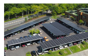
創エネルギー設備の整備
