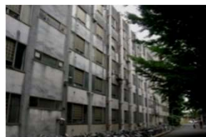
落下の危険がある外壁
