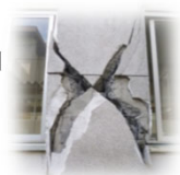
耐震化未完了の建物が 大規模地震により甚大 な被害を受けた例
