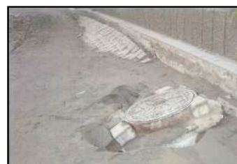
液状化による浮上（新木場）
