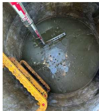
人孔内の土砂閉塞（羽咋市）
