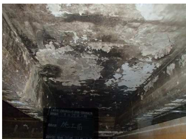
老朽化した水再生センター
