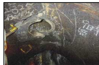
接続部の破損（新木場）
