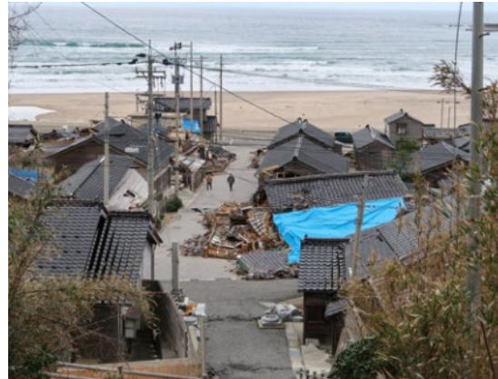
伝統的建造物群：黒島地区 （石川県輪島市） 令和6年1月能登半島地震による倒壊
