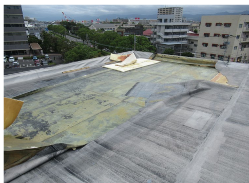
台風による屋上防水剥離
