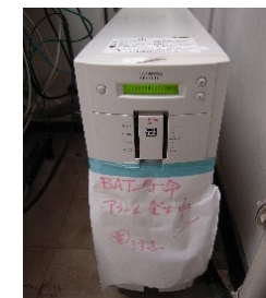
バッテリー(UPS)
