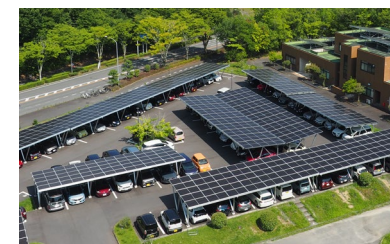
創エネルギー設備の整備
