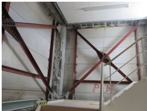
令和6年能登半島地震による屋内壁面の落下
