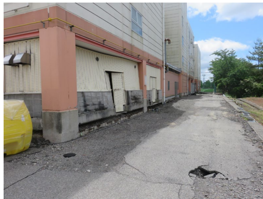
令和6年能登半島地震による地盤沈下
