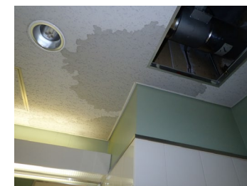
トイレの洗面用給水管からの漏水
