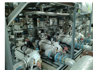
給排水配管設備
