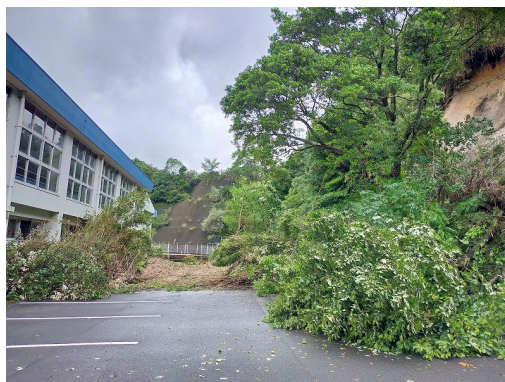
令和6年6月8日から7月30日までの間の豪雨による法面の崩れ
