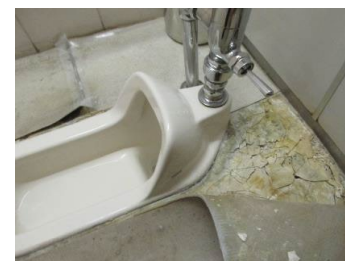
トイレの床の腐食・破損
