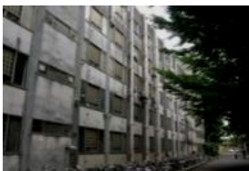
落下の危険がある外壁
