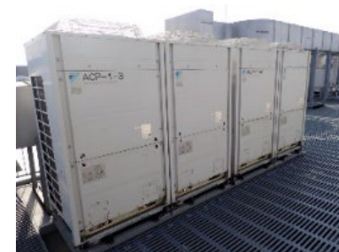
材料強度実験棟・先進構造材料研究棟 空調機
