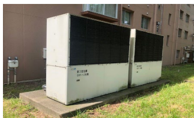
空調室外機（設置後16年）
