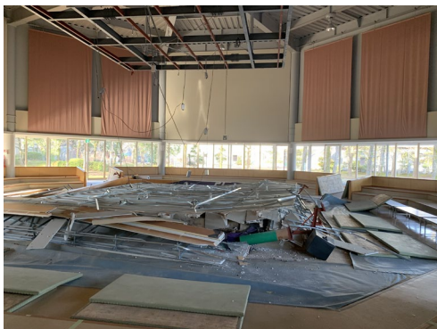
令和6年能登半島地震による天井落下
