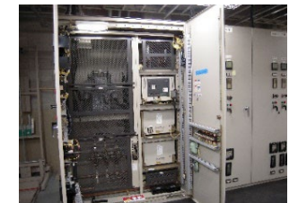
受変電装置（受電盤真空遮断器）（本館棟）
