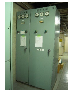
直流電源装置(本館棟)
