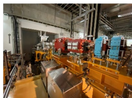
重粒子線照射設備外観
