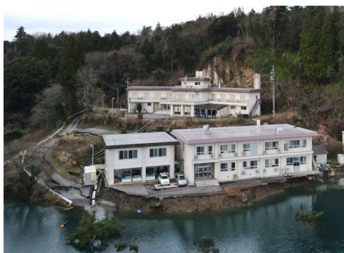
地震による護岸・道路の崩壊
