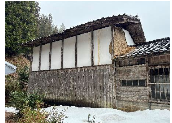
重要文化財黒丸家住宅米蔵ほか （石川県珠洲市） 令和6年1月能登半島地震による土壁の剥落
