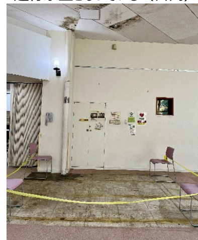
雨漏りにより床材が剥離し 通行禁止となっている（日高）
