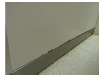
トイレの壁の腐食②
