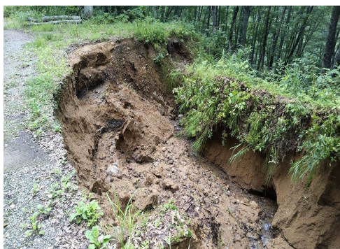
降雨による林道崩壊
