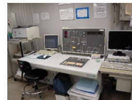
電力監視システム
