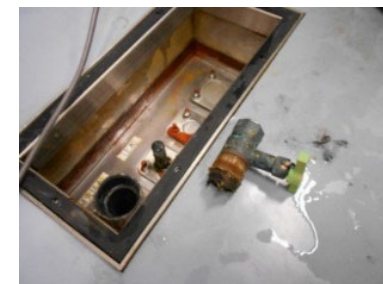
MANA棟実験室バンネ内配管
