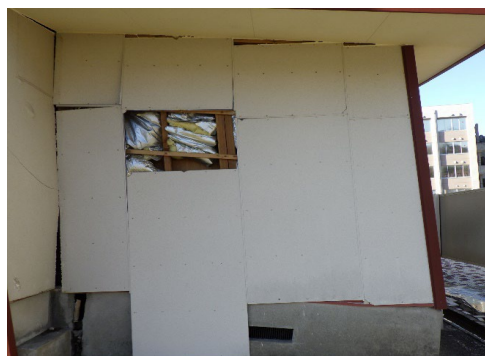
地震による外壁材の亀裂・落下
