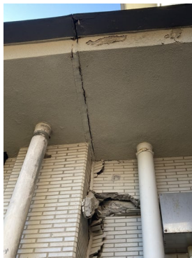
令和6年能登半島地震による外壁のクラック及び落下
