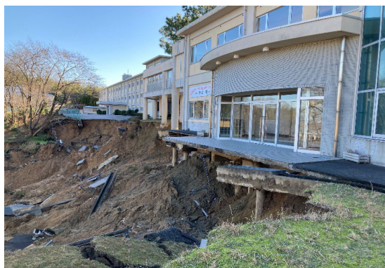
令和6年能登半島地震による校舎前地盤の崩れ（地中杭露出）
